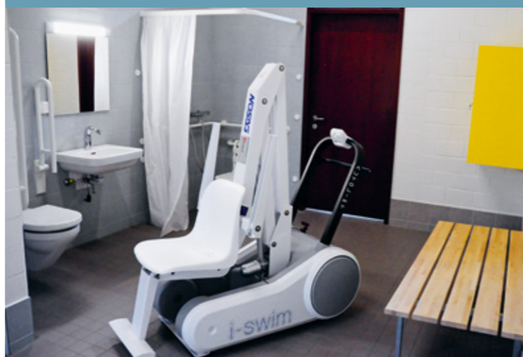
I-Swim-Lift in der neuen barrierefreien Garderobe
