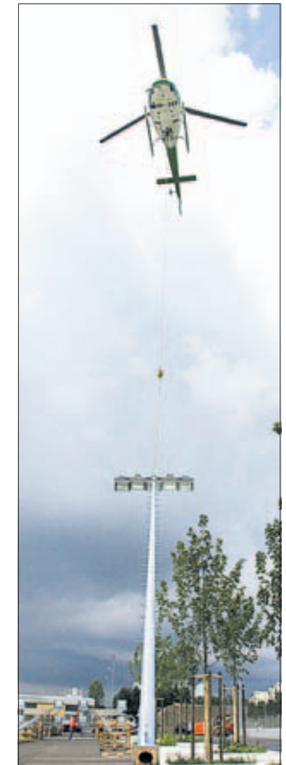
Zehn Masten à 18 bis 20 Meter Höhe sorgen mit 30 Leuchten auf allen Plätzen für eine Helligkeit von 200 Lux.
