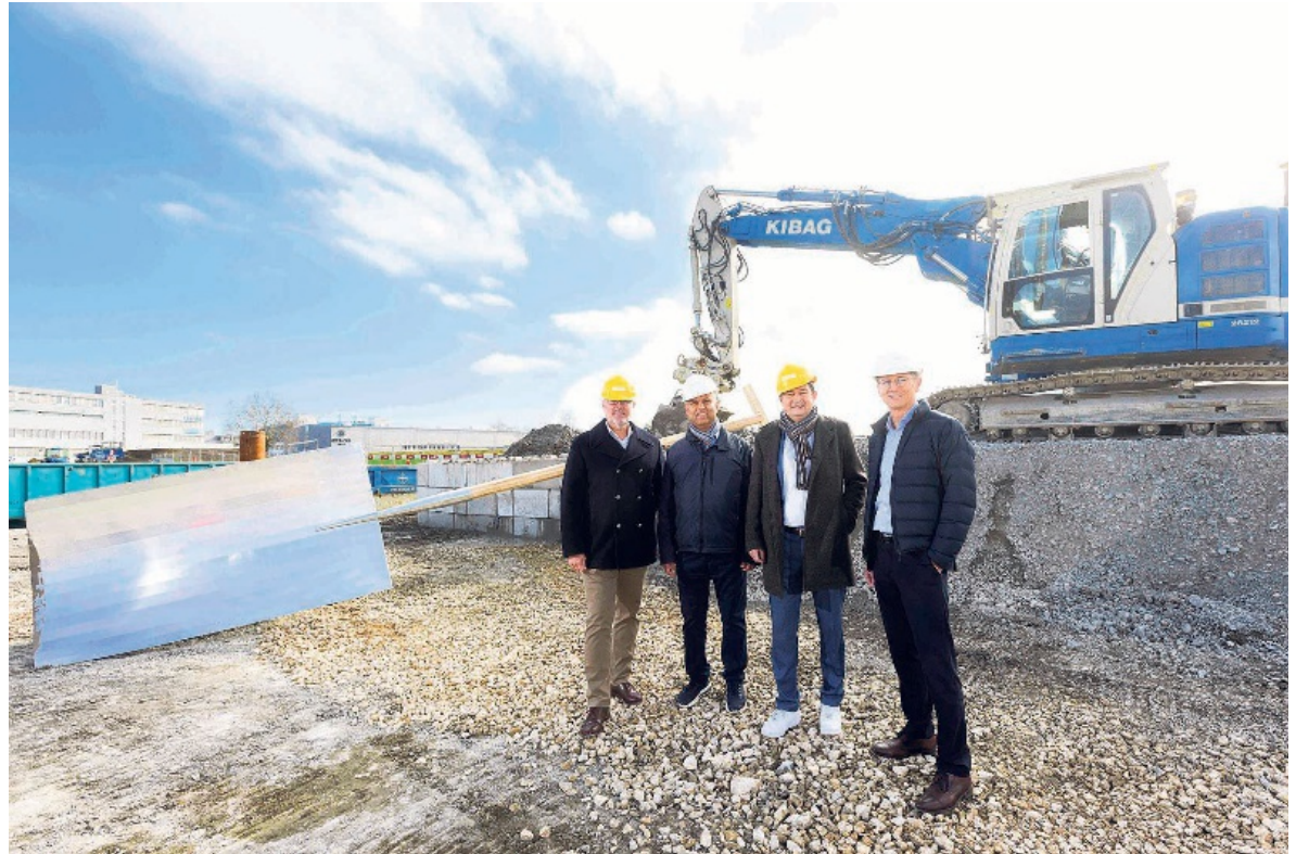
(V.l.): Edwin van Velzen, Vantage Data Centers, Jean-Philippe Pinto, Gemeindepräsident, Jörg Wild, CEO Energie 360°, Matthias Möller, Abteilungsleiter Energie Baudirektion Kanton Zürich.
