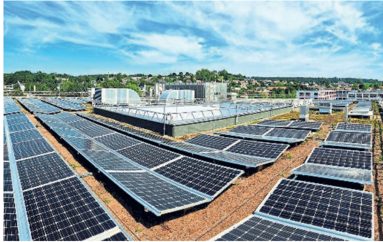
Photovoltaikanlage auf dem Gemeindehausdach.
